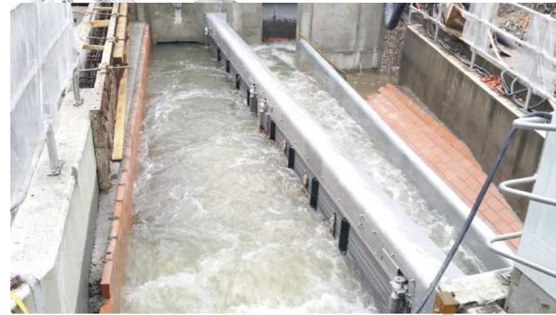
Räumeinrichtung (Abstreifer) im Abflussquerschnitt
