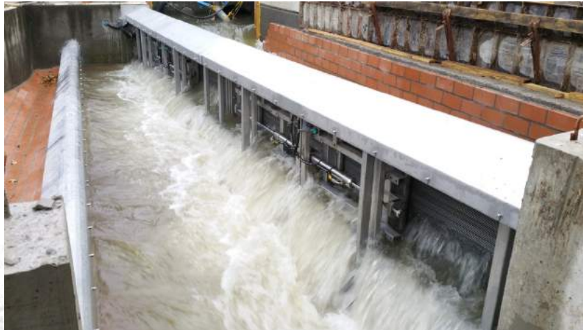
Horizontal durchströmter Stabrechen auf niedriger Schwelle
