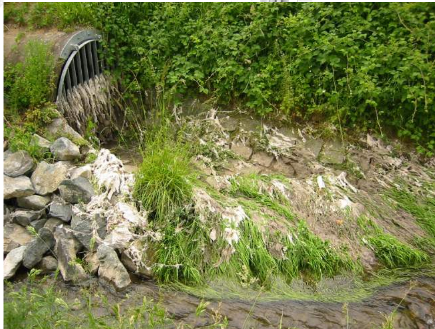
Verschmutzungen im Auslaufbereich einer Entlastungsanlage
