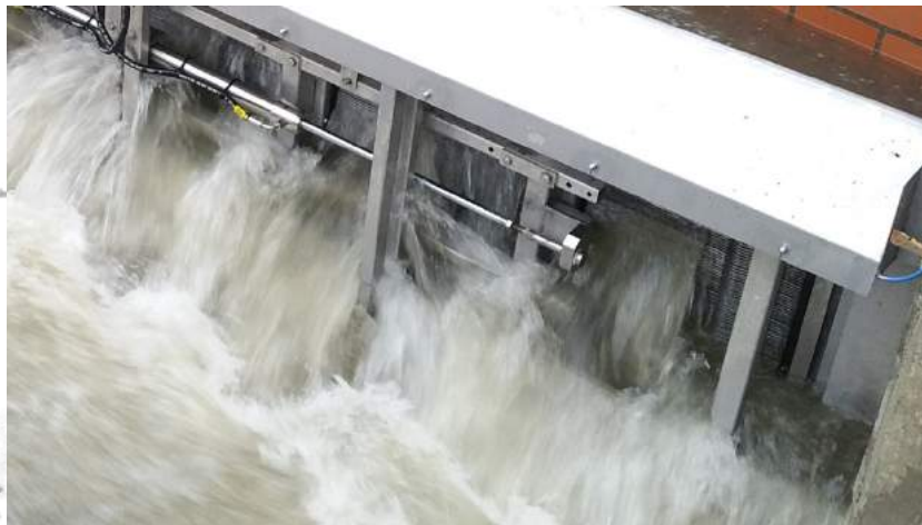
Horizontalstabrechenanlage mit abgereinigtem Rechenrost (maximale Räumgeschwindigkeit)
