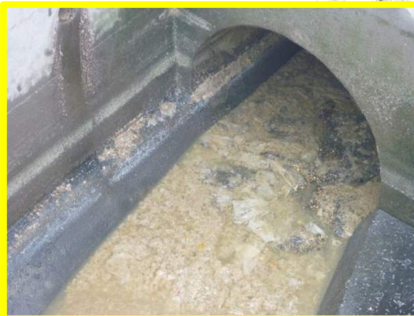
Kanalablagerungen nach einem Starkregenereignis
