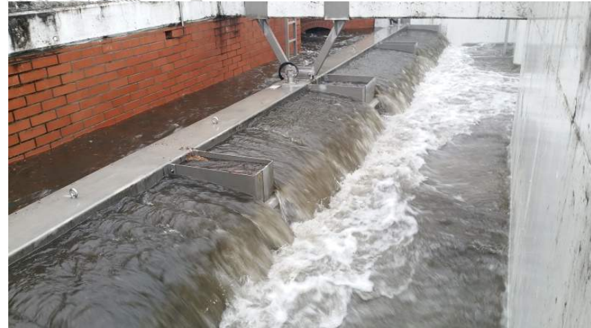
Vertikal durchströmter Lochblechrechen auf hoher Schwelle
