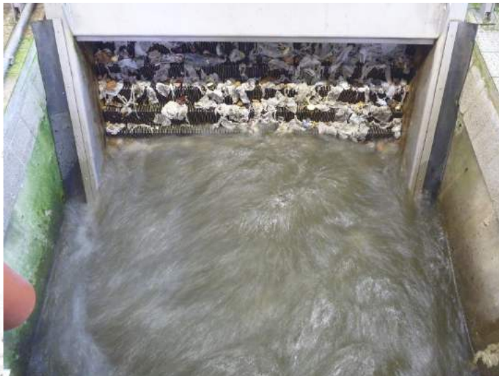
Turbulenz an der Hauptrechenanlage der Kläranlage
