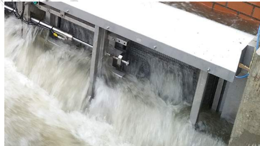
Horizontalstabrechenanlage im Filterbetrieb (reduzierte Räumgeschwindigkeit)
