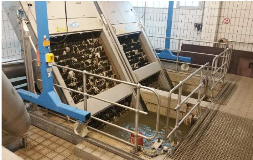
Hauptrechenanlage der Kläranlage (Filterstufenrechen)
