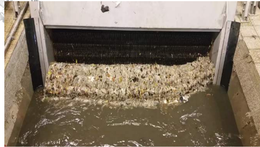
Rechengutwalze an der Hauptrechenanlage der Kläranlage
