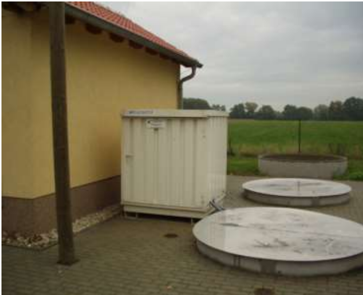
Dosierstation von aluminathaltiger Natronlauge in Sammel tanks der Vakuumentwässerung
