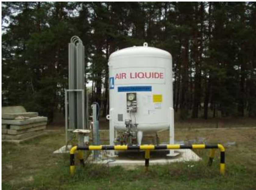
Stationäre Dosieranlage von reinem Sauerstoff
