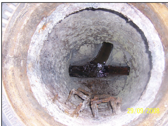
Abbildung 2: biogene Schwefelsäurekorrosion an einem Abwasserschacht
