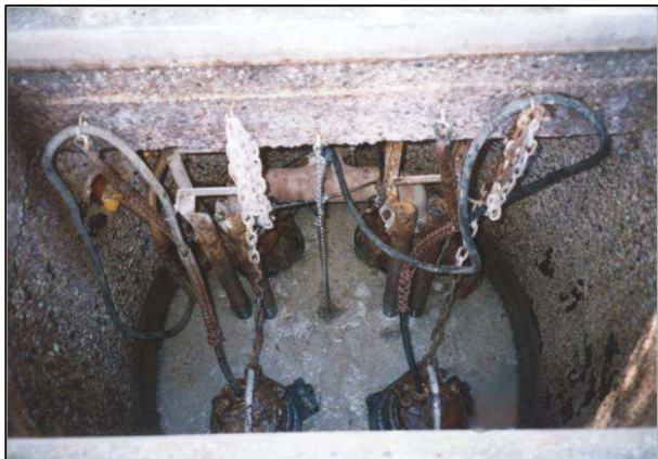
Abbildung 1: biogene Schwefelsäurekorrosion an einem Abwasserpumpwerk
