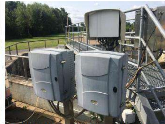
Bild 3: PO4-P Messung im Verteiler zur Nachklärung
