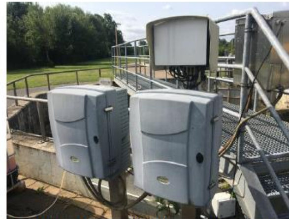
Bild 3: PO4-P Messung im Verteiler zur Nachklärung
