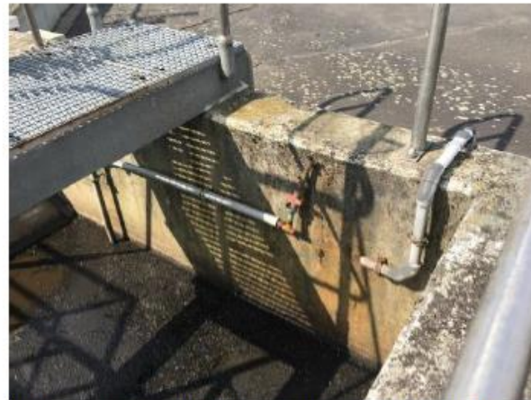
Bild 2: Zweite Dosierstelle Verteiler zum NKB aktuell nicht in Betrieb
