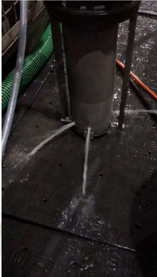
Spülung des Filterelements
