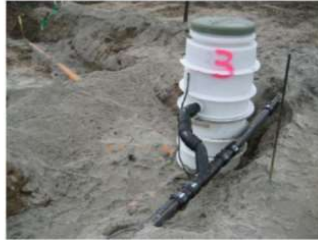
Bild 3: Vakuumschacht mit Anschluss Vakuumleitung
