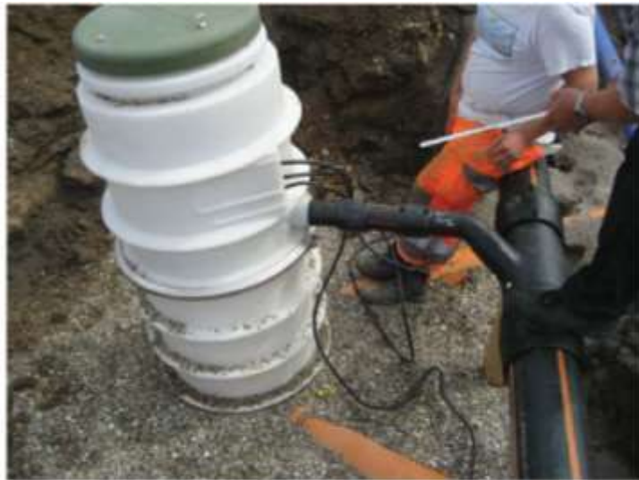
Bild 4: Vakuumschacht mit Anschluss Vakuumleitung
