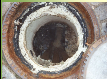
Schacht mit Korrosion
