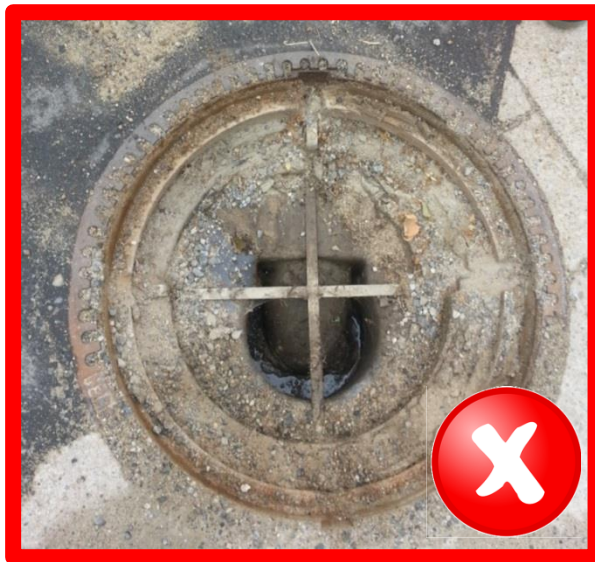
Platte oben – System muss gereinigt werden
