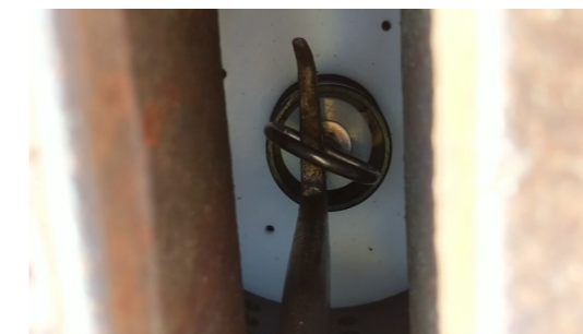
12. Bedienung bei geschlossenem Gitterrost mit handelsüblichem Schachthaken möglich
