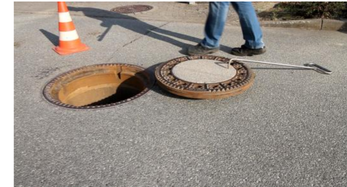
2. Schachtdeckel öffnen und Schmutzfang entnehmen (Schmutzfang wird nicht mehr benötigt)
